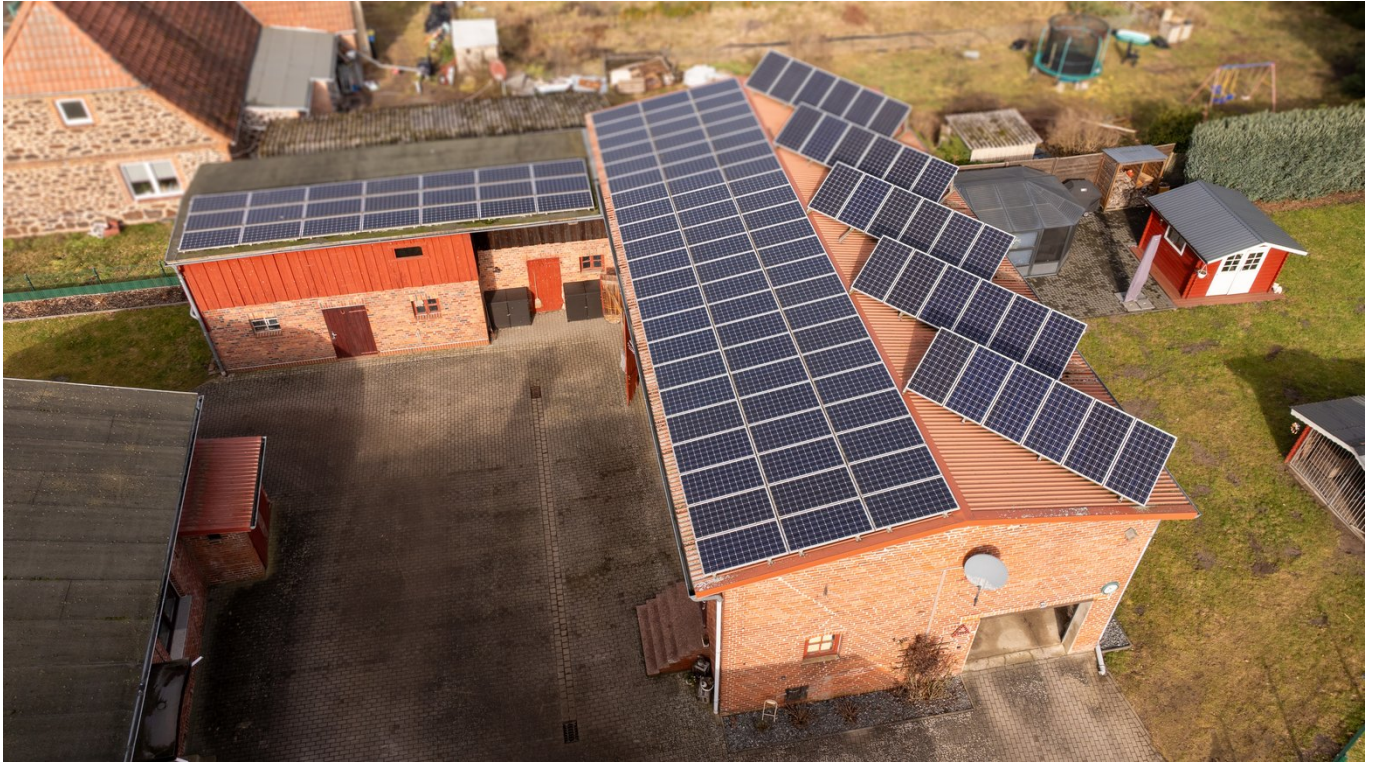
Nebengebäude mit Photovoltaik
